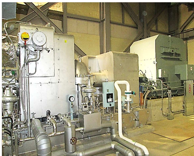
(蒸気タービン発電機)
