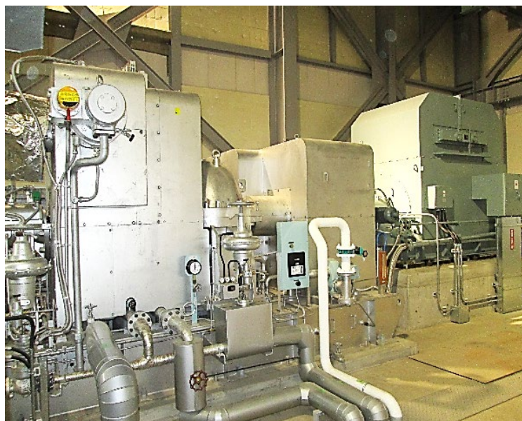
(蒸気タービン発電機)
