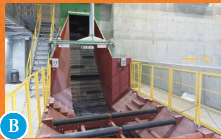
B 受入コンベヤ 受入コンベヤに投入したごみは、破碎、選別などのラインに運ばれます。
